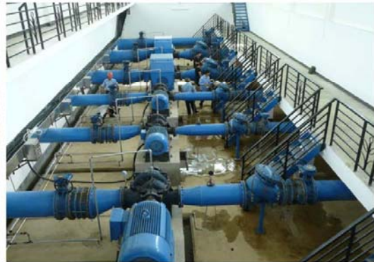
水厂机泵管道系统
