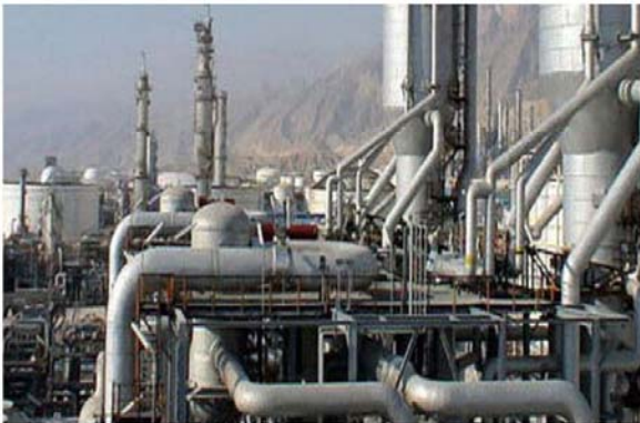
冶金石化管道系统
